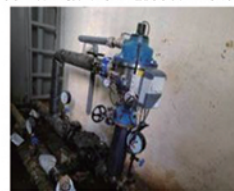
换热站安装过滤器后照片
