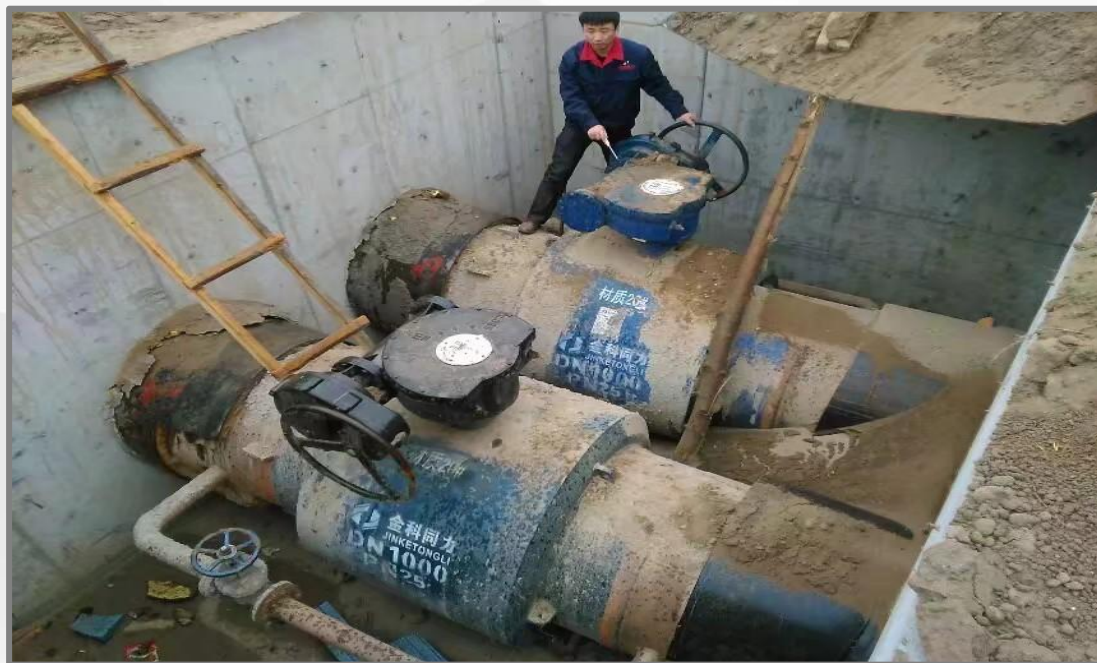
山西临汾热力有限公司安装现场
