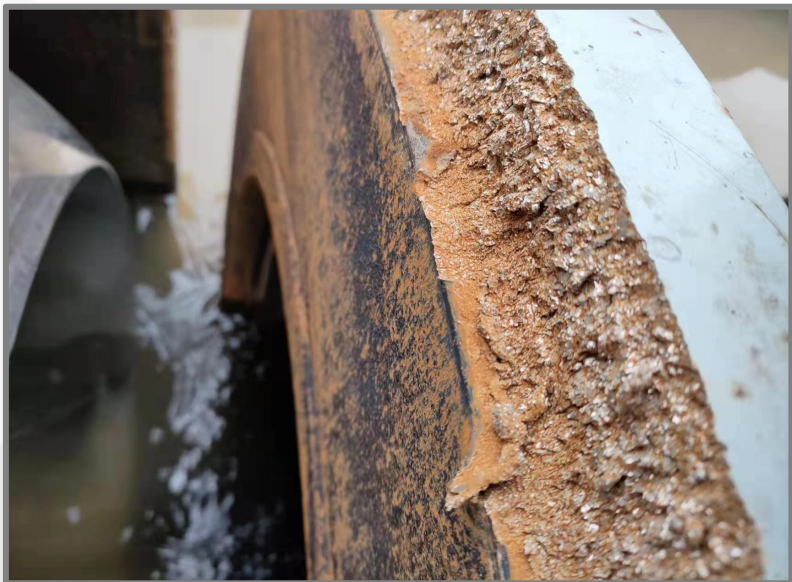
DN1000钢板制作焊接球阀拉断现场
