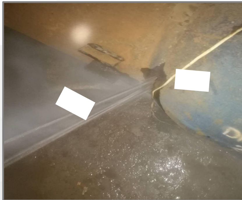
DN1000椭圆形结构被轴向力撕裂现场
