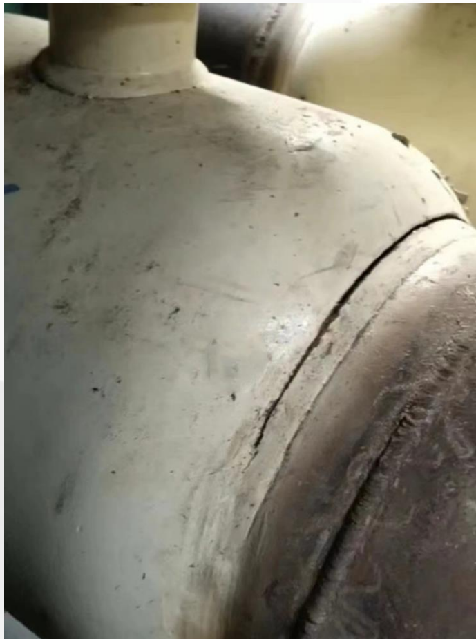
DN1000椭圆形结构被撕裂现场
