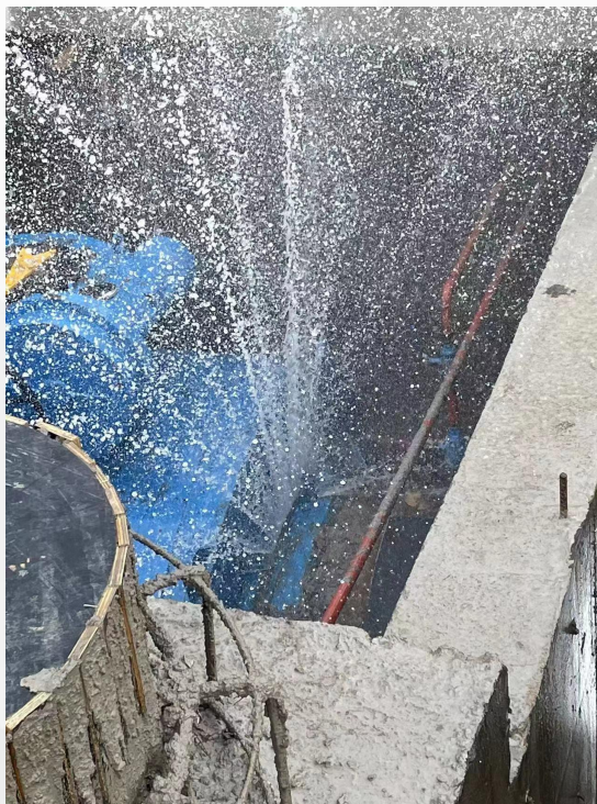
DN1400钢板制作焊接球阀撕裂现场
