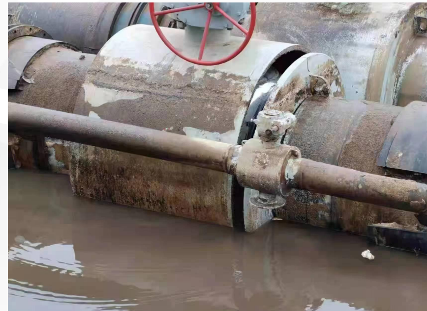
DN1000钢板制作焊接球阀拉断现场
