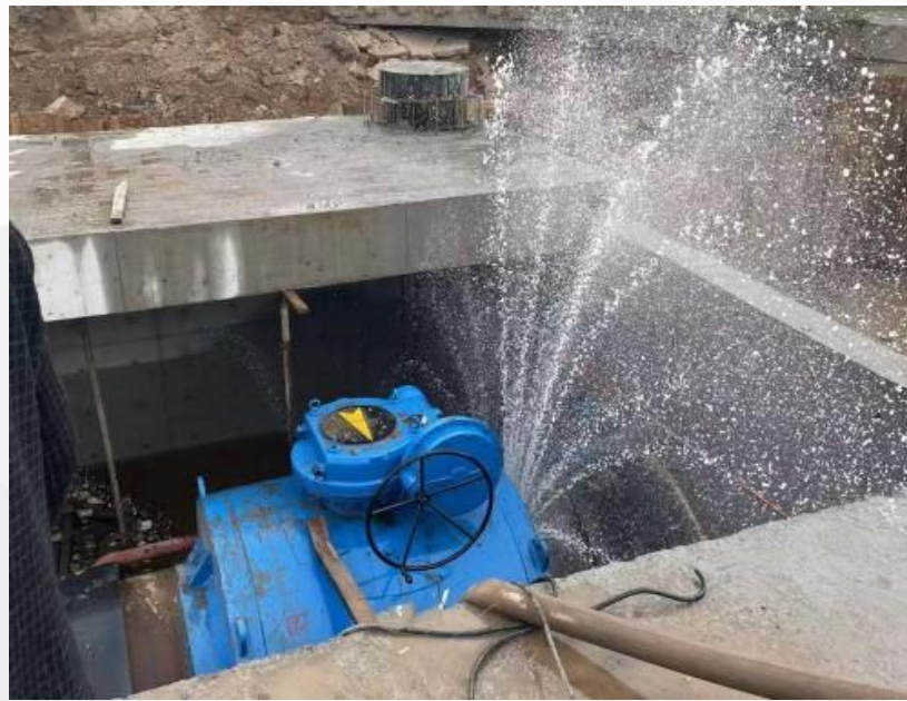
DN1400钢板制作焊接球阀撕裂现场
