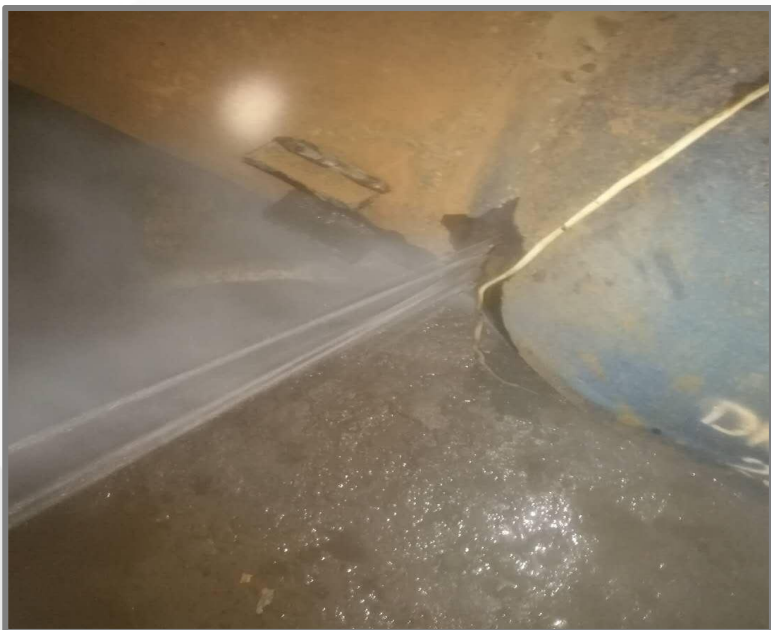
DN1000椭圆形结构焊接球阀撕裂现场
