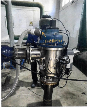
图 2 安装在现场的除污器
