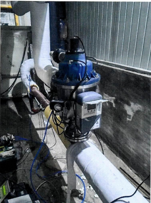
图 2 安装在现场的除污器
